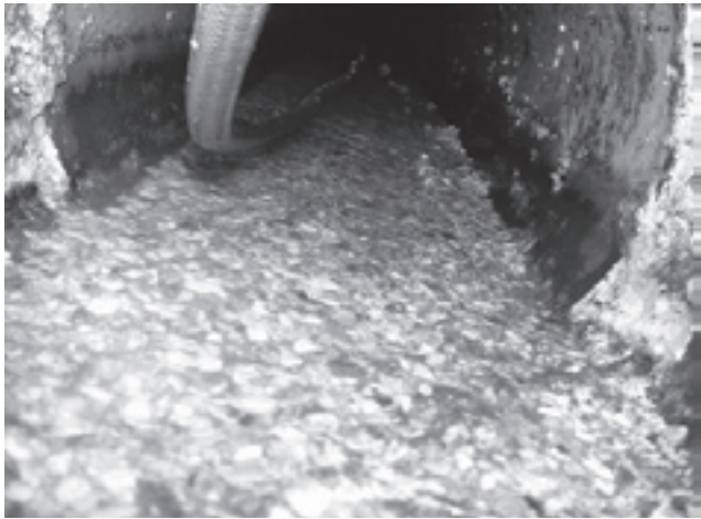
写真2 毎年清掃物件堆積状況
