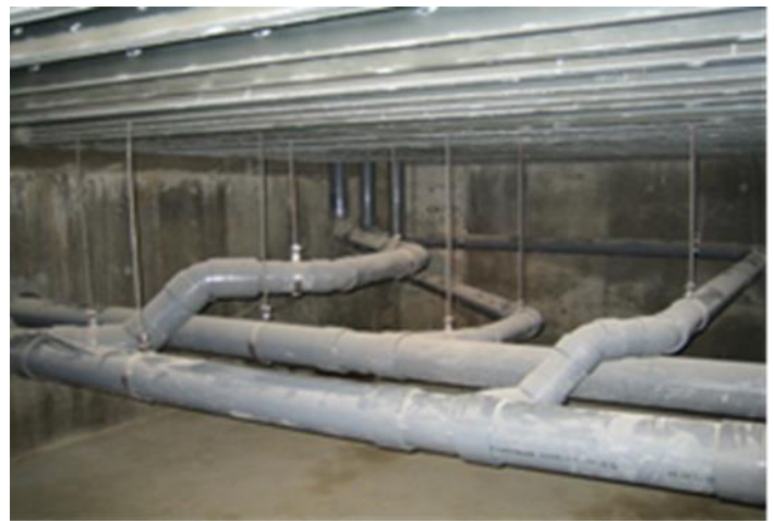
写真 1 系統ごと横主管合流部に掃除口のない例
