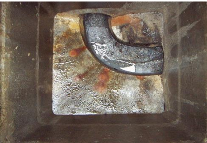
写真 4 管底に堆積した粉砕物
