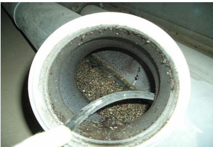
写真 6 管底に堆積した粉砕物
