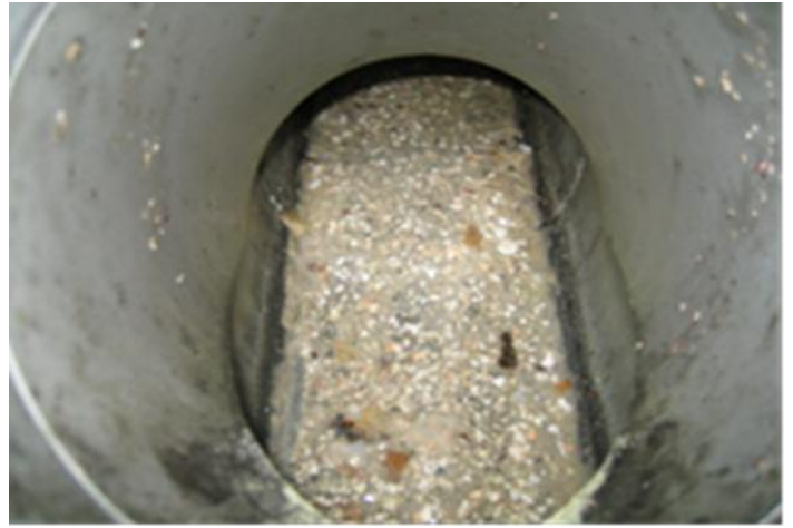
写真 3 管底に堆積した粉砕物
